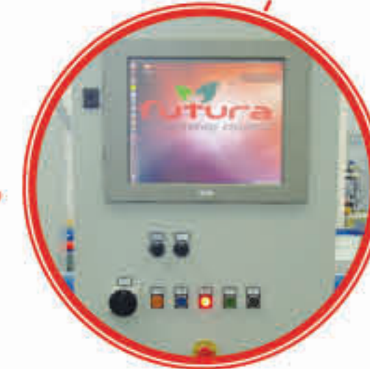
PANEL DE CONTROL GENERAL CON CONEXIÓN REMOTA POR TELEASISTENCIA
